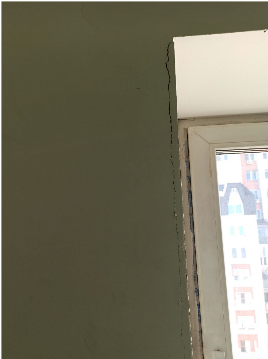
Рисунок Г.1 – Вертикальная трещина в результате отслоения штукатурного слоя откоса оконного проема лестничной клетки между 7 и 6 этажами шириной раскрытия до 1,0 мм
