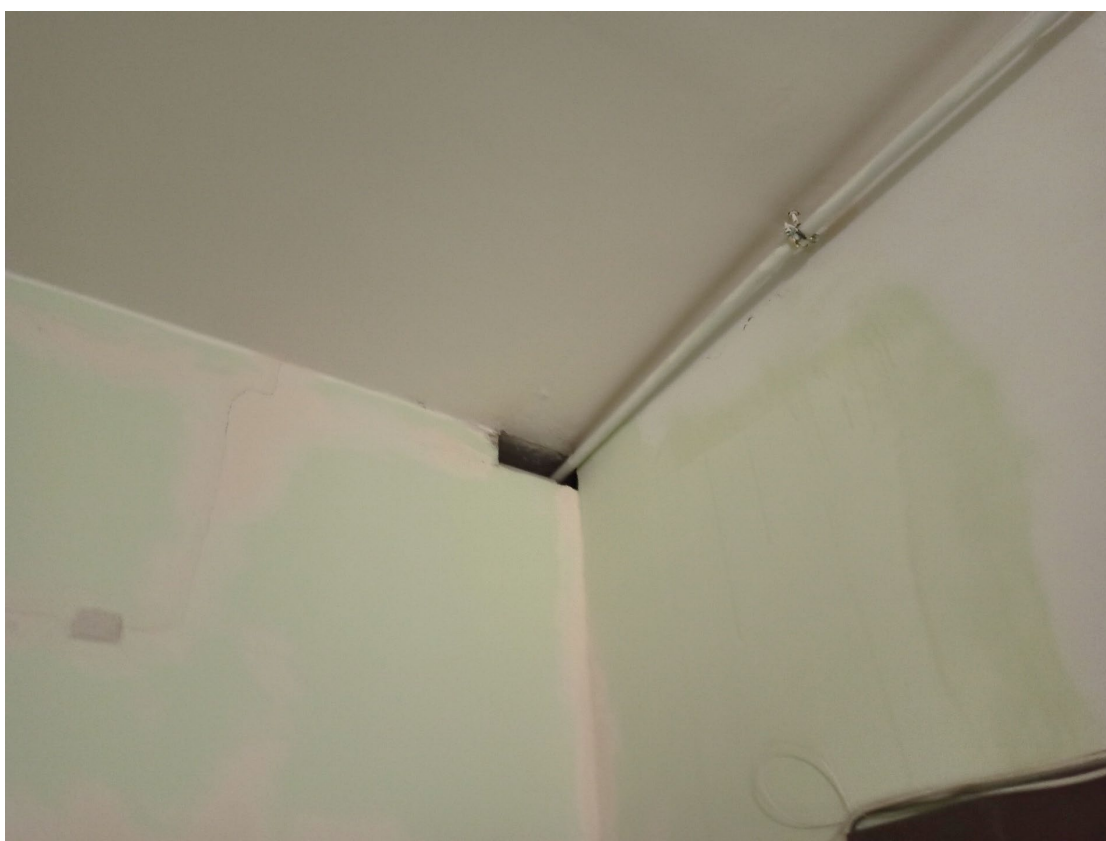
Рисунок Г.8 – Отсутствует гильза в месте пересечения трубопровода водоснабжения с внутренней стеной 9 этажа необходимая согласно п. 5.2.21 СП 55-103-2004 «Конструкции с применением гипсовых пазогребневых плит»
