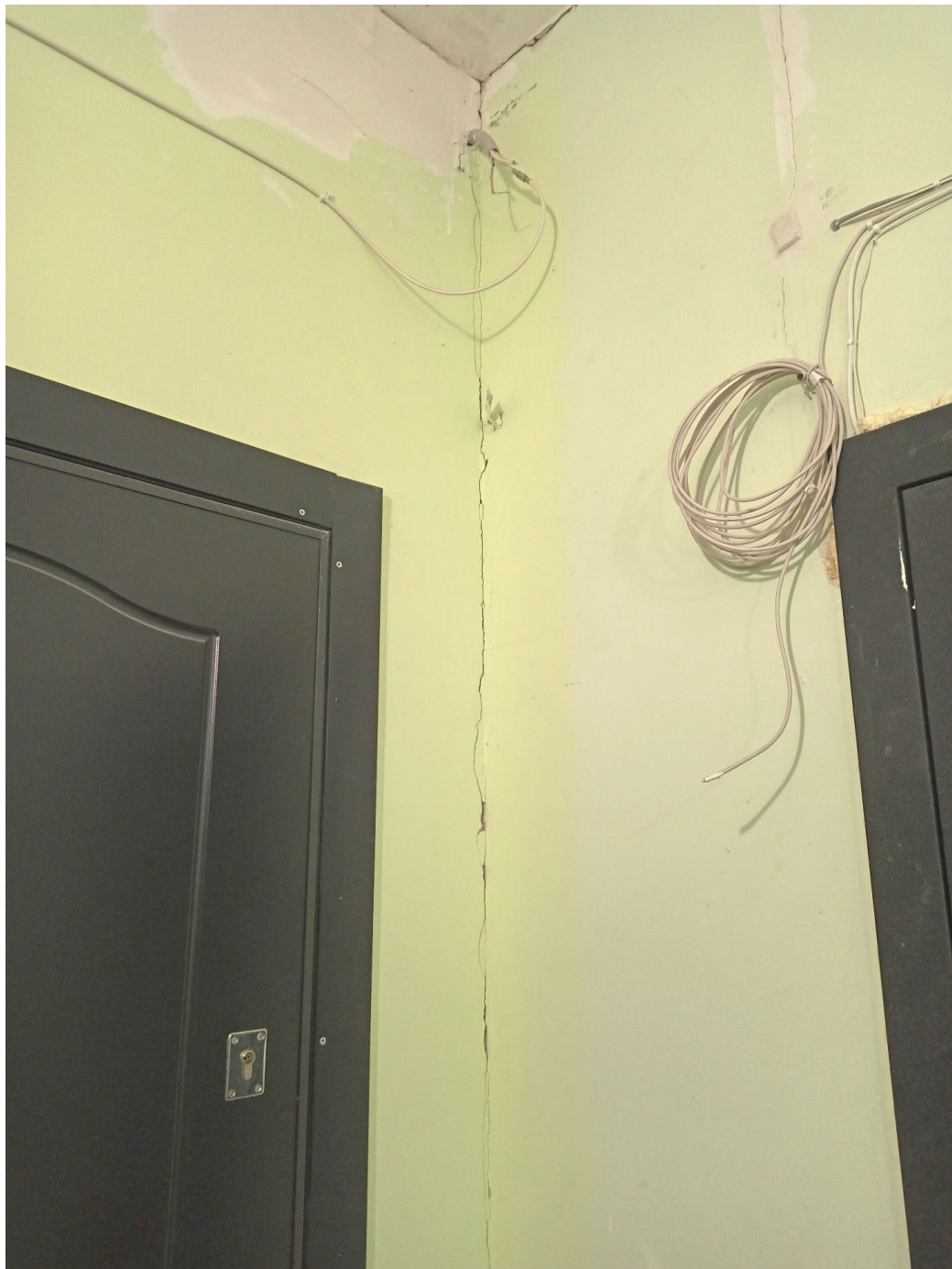
Рисунок Г.6 – Вертикальная трещины в узле сопряжения внутренних стен 8 этажа отделяющих квартиры от коридора общего пользования между квартирами шириной раскрытия до 1,0 мм
