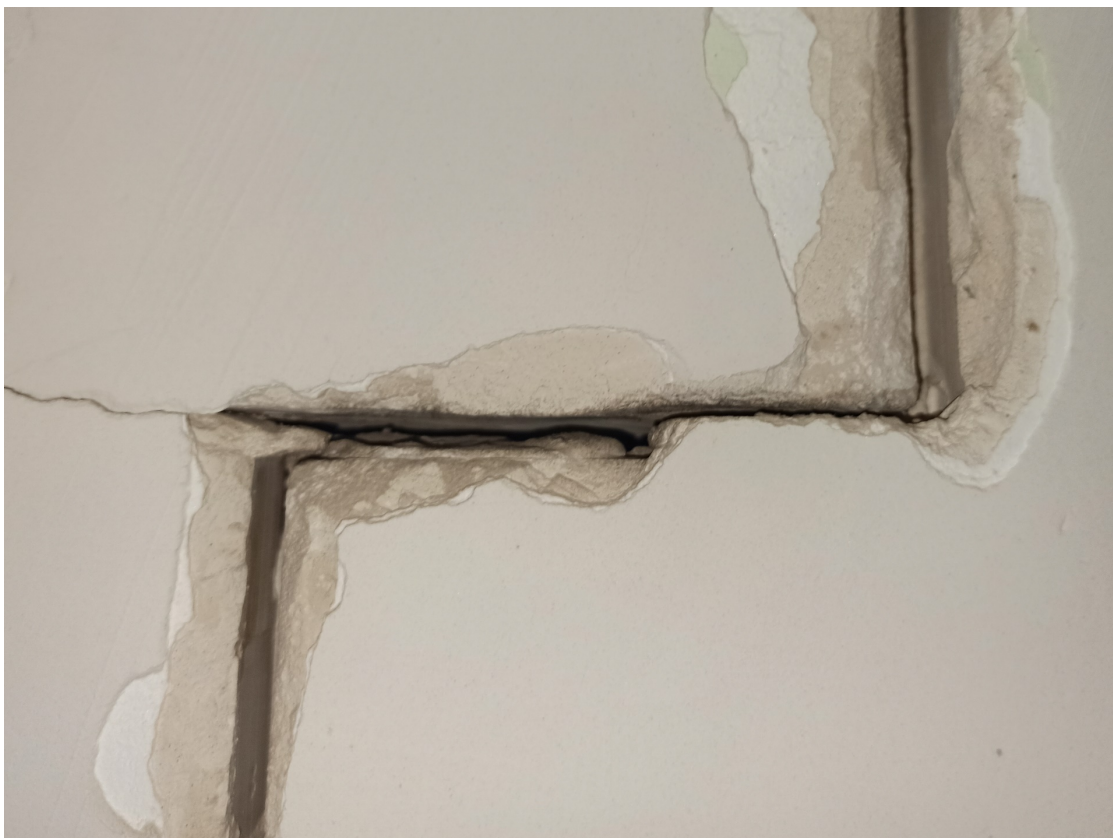
Рисунок Г.3 – Толщина швов пазогребневых плит внутренней стены составляет около 20 мм что не соответствует требованиям п. 6.1.11 СП 55-103-2004 «Конструкции с применением гипсовых пазогребневых плит»
