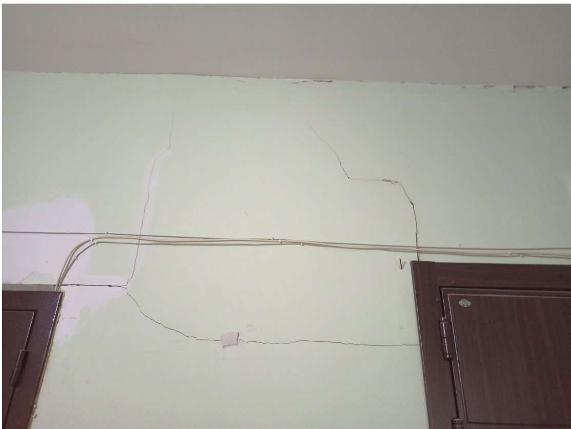
Рисунок Г.4 и Г.5 – Горизонтальная, наклонные и вертикальные трещины в пазогребневых плитах внутренних стен отделяющие квартиры от коридора общего пользования между квартирами шириной раскрытия до 5,0 мм от углов дверных проемов
