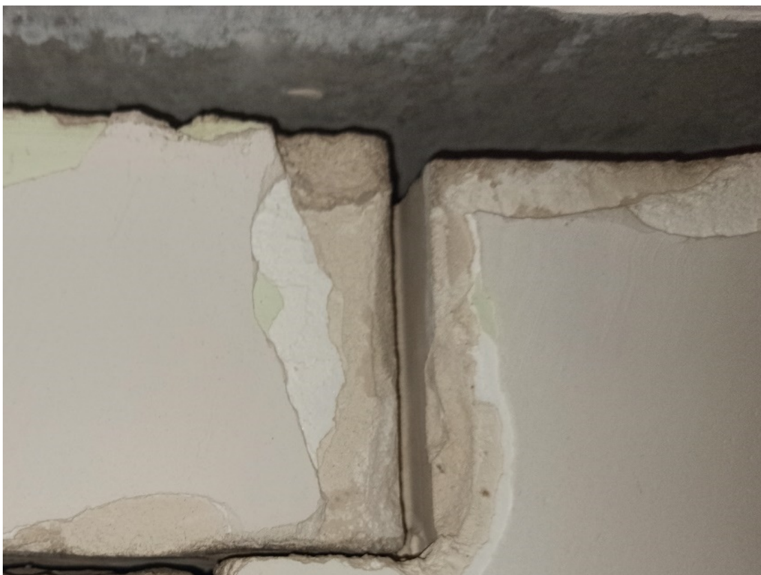
Рисунок Г.7 – Последний ряд внутренней стены выполнен из пазогребневых плит с прямыми гранями что не соответствует требованиям п. 6.1.13 СП 55-103-2004 «Конструкции с применением гипсовых пазогребневых плит»
